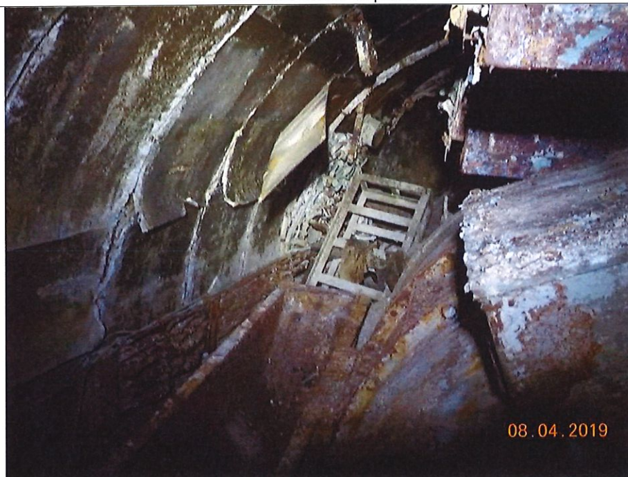
Vista del Locale Motore elettrico
