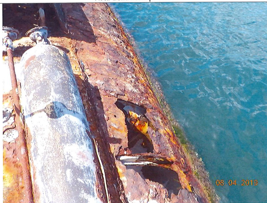
Vista dello scafo leggero a prora completamente corrosivo
